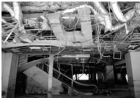
津波で破壊されたマイヤ店舗の内部（大船渡駅付近）
