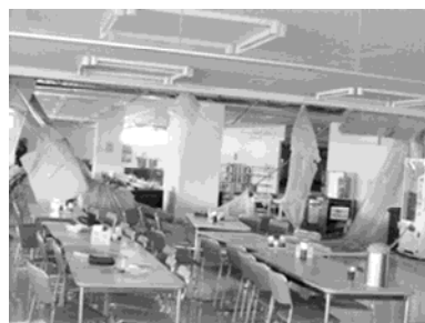
食堂の天井が落下
